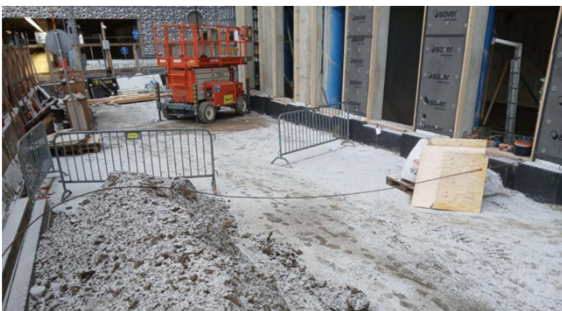
Harjateräksen tippuminen 8 kerroksesta 11/2025
